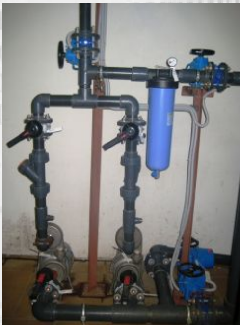
Автоматизированная насосная установка откачки пермеата и обратной промывки мембран
