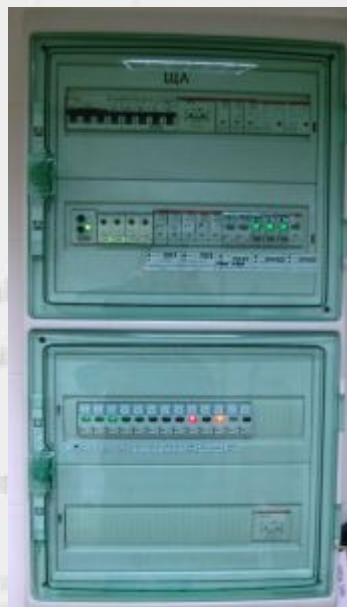
Центральный щит автоматизации производственного процесса МБР
