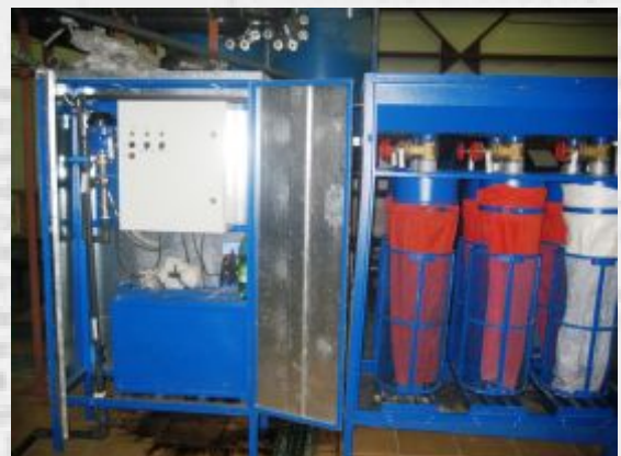
Установка механического обезвоживания избыточного ила
